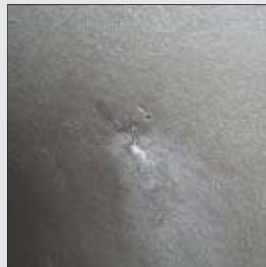
Kalciumkarbonatudfældning i betonrør. Kalciumkarbonaten har lukket den gennemgående defekt i betonen 100 %.
