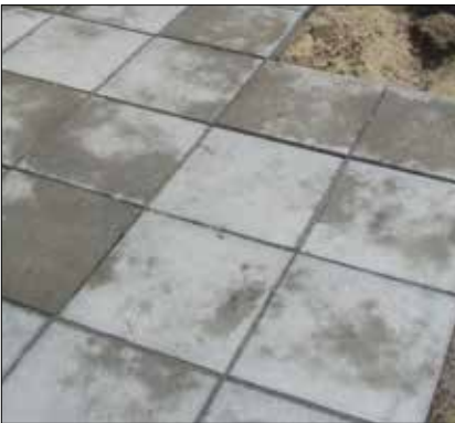
Figur 2.48. Varierende porestruktur kan give et udseende som dette, når fliserne tørrer ud efter regnvejr. Det er ikke tegn på manglende modstandsevne over for påvirkninger fra frost-tø og salt.
