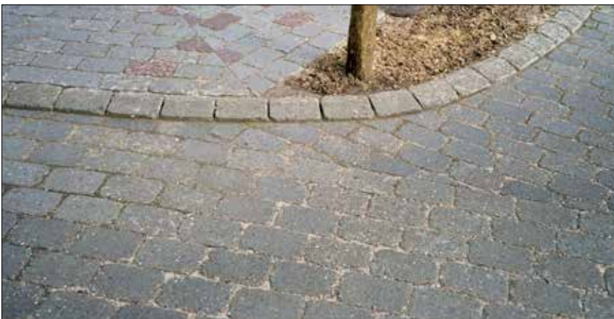
Figur 4.16. I denne belægning har der været gravet op for at reparere telekabler.
