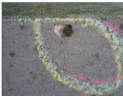
Figur 2.45. Et hul i overfladen, som følge af et porøst materiale i tilslaget, opstår normalt indenfor det første år.
