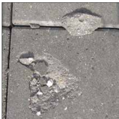
Figur 2.46. En "kalkspringer", dvs. en vandmættet kalksten, har udvidet sig i frostvejr og presset en flage af betonen.
