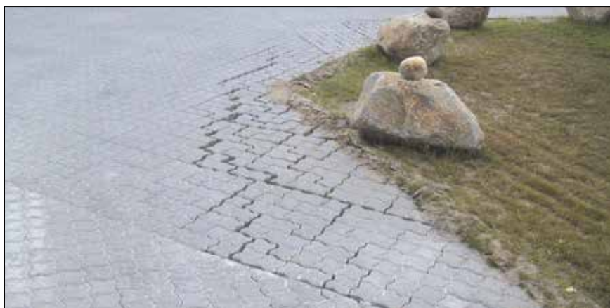
Figur 3.45. Resultatet af manglende kantsikring.
