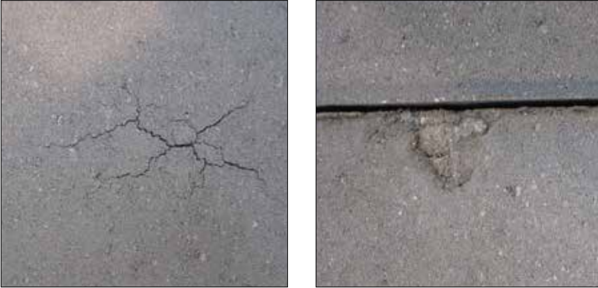
Figur 2.47. Til venstre ses revner i overfladen som følge af fejl i støbningen eller håndteringen. Til højre et eksempel på mangelfuld fyldning af formen, der har givet en fordybning i kanten af flisen. Sådanne fliser skal sorteres fra før lægningen.
