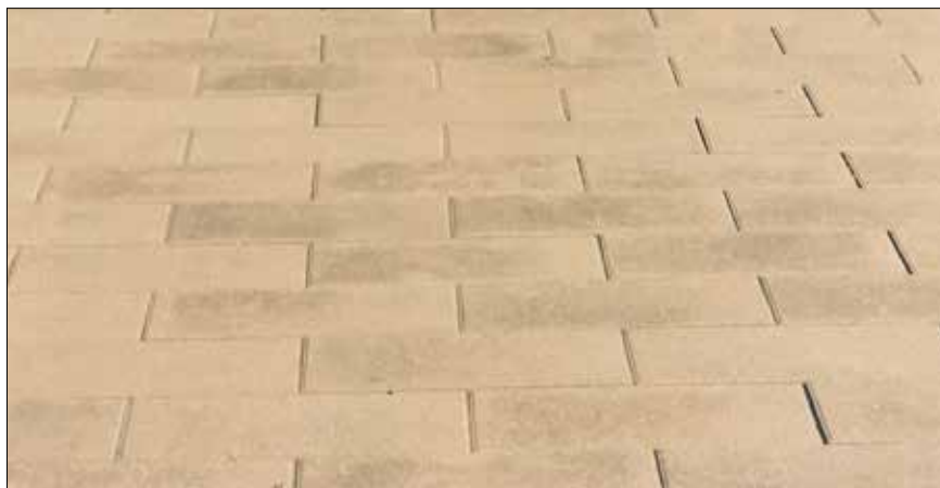
Figur 4.10. Disse skæmmende brunlige plamager er opstået, fordi kalkudfældninger har bundet finstof fra fugegrus, der har ligget på belægningen. Dette kunne være undgået ved at feje belægningen ren efter fugningen.
