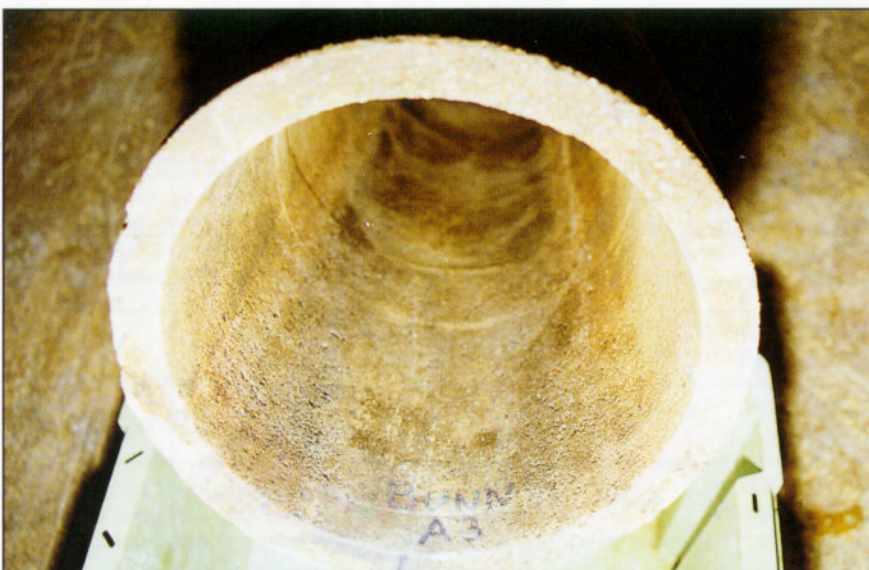
Spildevandsrøret viser kun få tegn på udvaskning efter 68 år i jorden. Kendskabet til ældre rørs betonkvalitet er vigtigt for fastlæggelse af nye rørs levetid.
